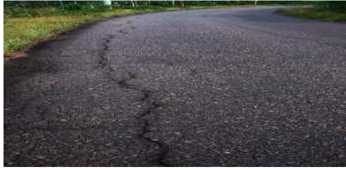
Gambar 2.9 Retak Memanjang ( Longitudinal Cracks )
