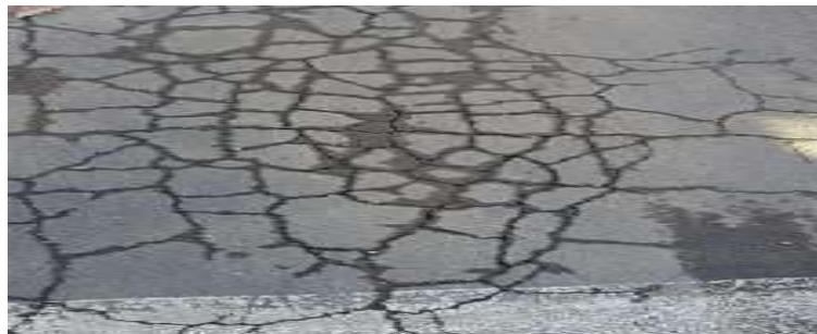
Gambar 2.4 Retak Kulit Buaya ( Alligator Cracking ) (Sumber: Suwandi, 2018)
