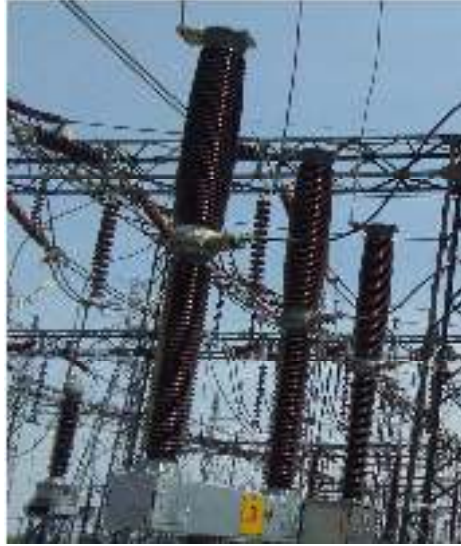
Gambar 3.4 Pemutus Tenaga ( PMT ) / Circuit Breaker ( CB )
