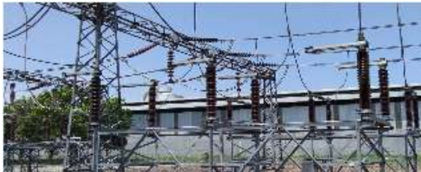
Gambar 3.5 Pemisah (PMS)/Disconnect Switch (DS)
