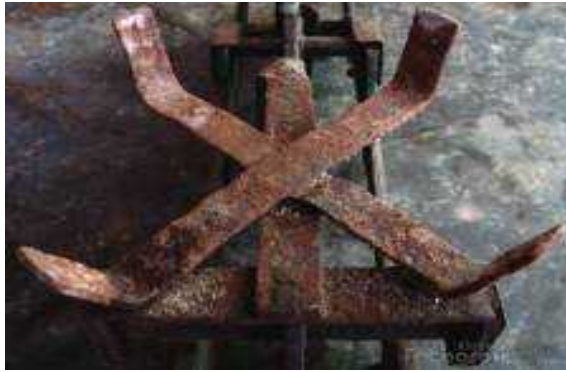
Gambar 2.1 Logam yang mengalami korosi
