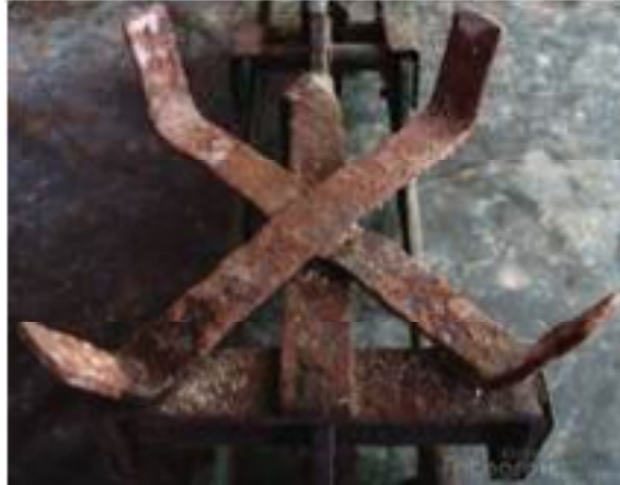
Gambar 2.1: Logam yang mengalami korosi
