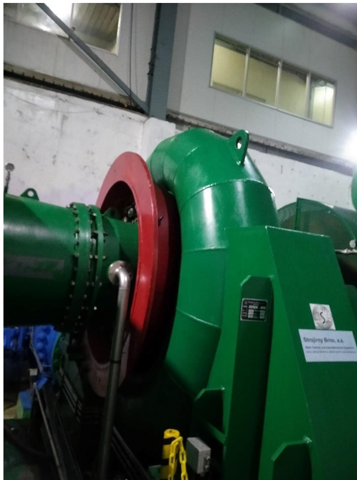
Gambar 3.2 Turbin Francis pada PLTA Pakkat
