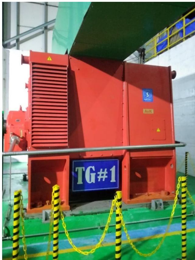
Gambar 3.3 Generator Pada PLTA Pakkat
