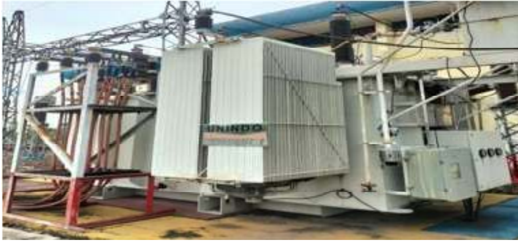
Gambar 3.2 Trafo Daya 2 GIS Mabur
