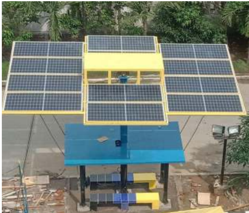
Gambar 3.1 PLTS 5 Kwp Riset Kedaireka UHN MEDAN
