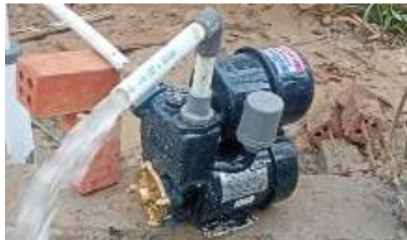
Gambar 2.3 Pipa Yang Tersambung Dengan Pompa Air.
