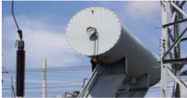
Gambar 2.10 Konservator Minyak Transformator
