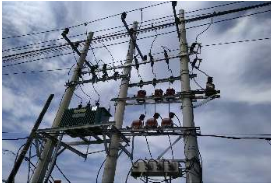
Gambar 2.2 Saluran Udara Tegangan Menengah (SUTM)
