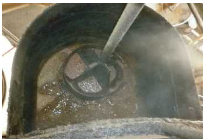
Gambar 3.6 Tangki lumpur (Sludge Tank)
