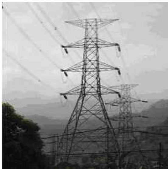
Gambar 2-2. Saluran udara (Overhead Lines).
