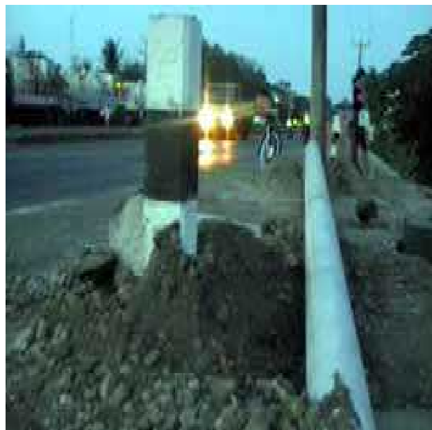
Gambar 2-3. Saluran Kabel Bawah Tanah (Underground Cable).
